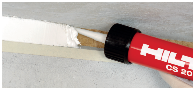
③ Fuge Wand zur Decke.
