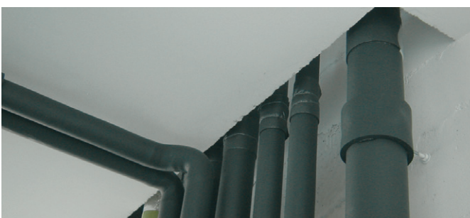
Nichtbrennbare Rohre mit brennbarer Isolierung.
